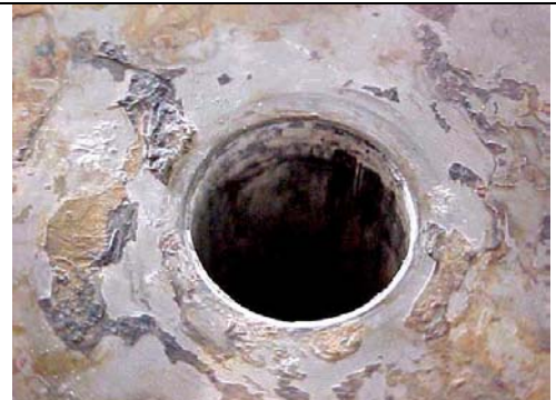
Foto 7: Incrustação dura na superfície da guia do suporte do disco da PSV-601.
