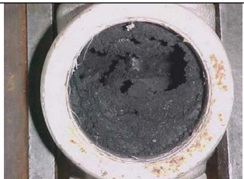
Foto 9: interior e conexão de saída da PSV-102 obstruídos.
