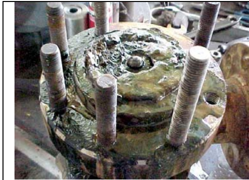
Foto 6: interior da PSV-601, que não abriu devido incrustação e sujeira em todo o interior, causada por falha de anel “O” da haste do suporte do disco.
